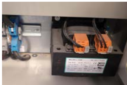
I caricabatterie a tiristori sono solitamente montati a vista nell'armadio dell'impianto e sono facilmente riconoscibili per la forma tipica del trasformatore.
