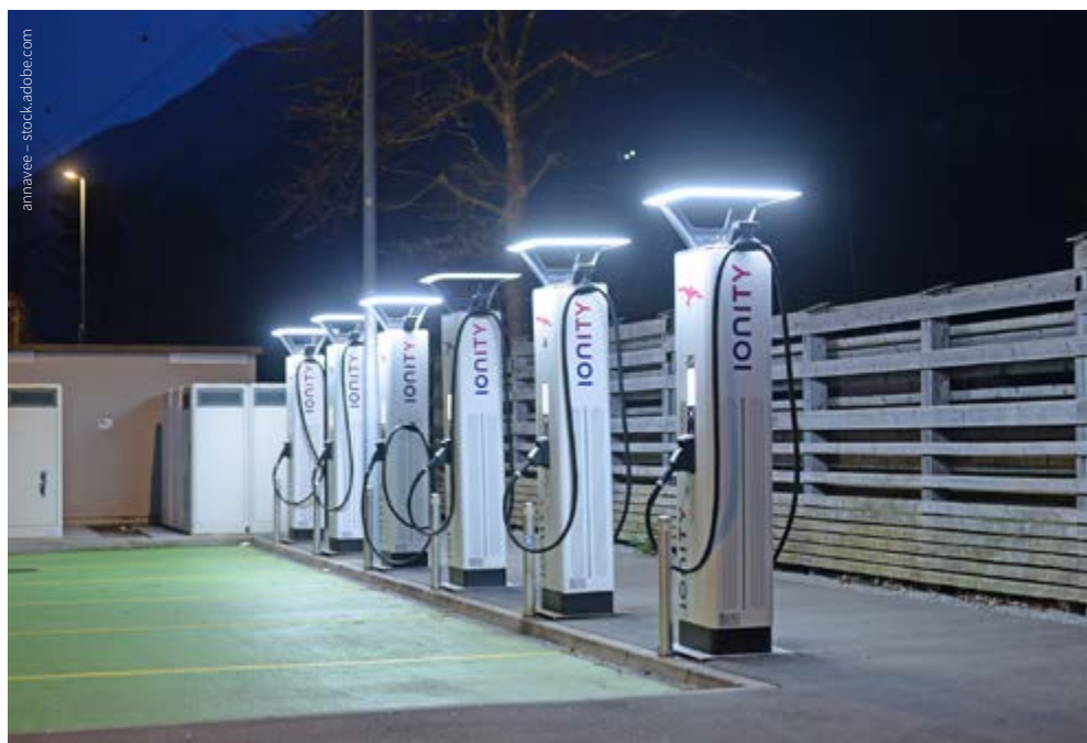
Actuellement, la Suisse compte environ 14 000 stations de recharge sur quelque 6370 sites. Au cours des 10 à 15 prochaines années, afin de répondre aux besoins futurs, au moins 3500 points de recharge rapide de 100 kW et 8000 points de recharge de 50 kW supplémentaires devront être installés.
