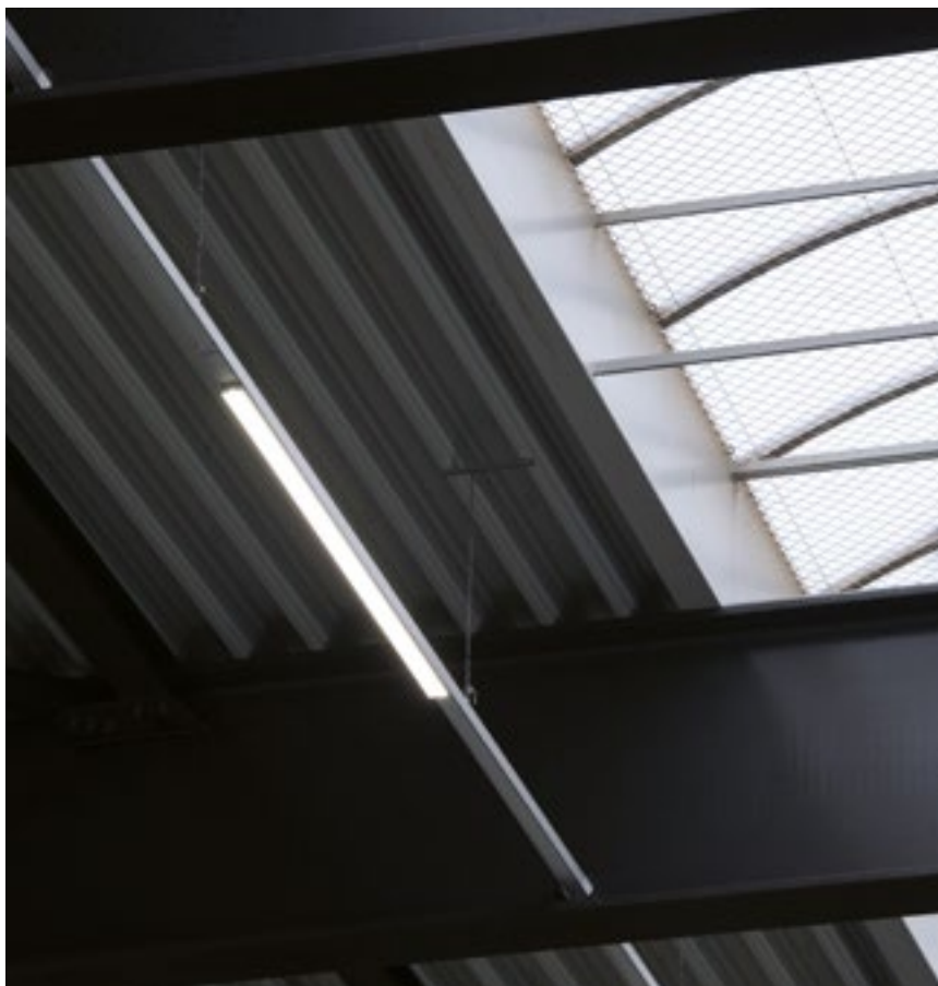
S'il y a suffisamment de lumière du jour dans le hall de production à travers les verrières, la commande DALI réduit automatiquement l'éclairage LED.
